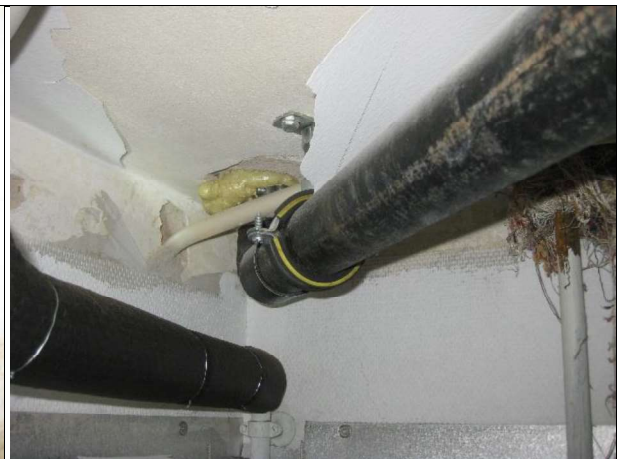
Gennemføring i nr. 10.1.7 til overliggende lejlighed er ikke tætnet korrekt. Rørgennemføring er tætnet med tvist.
