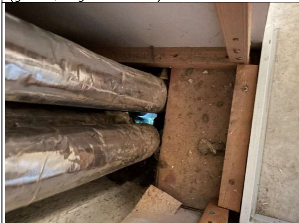
Udstøbning mangler i etagedæk til kælderetage i lejl. 6.0.7
