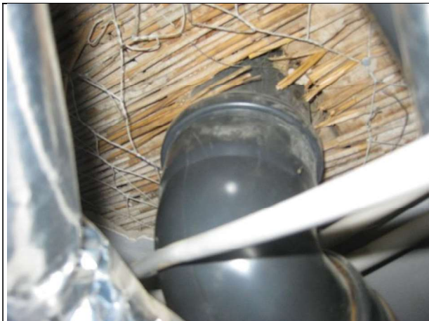
Skade på puds/etagedæk i nr. 6.0.8 (gennemføring ikke tætnet)
