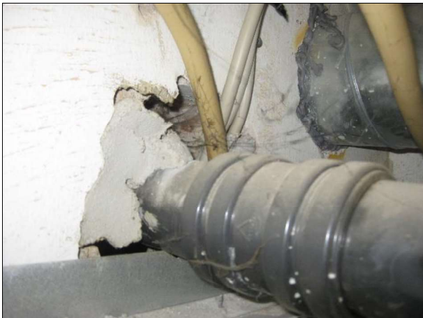
Afløb ført ind i oprindelig skorsten er ikke tætnet - stueetage i administration. Væggen er sandsynligvis brandsektionsvæg
