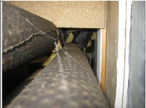
Gennemføring i nr. 10.1.6 til overliggende lejlighed er ikke tætnet.
