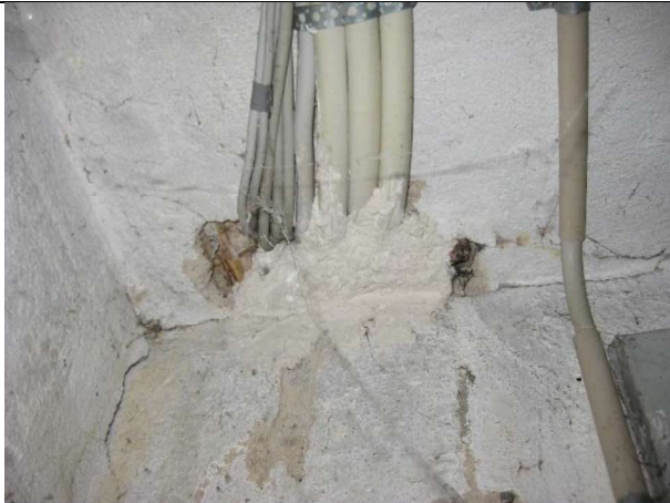
Opføring af kabler fra kælder til stueetage er forsøgt tætnet – tvivlsom kvalitet
